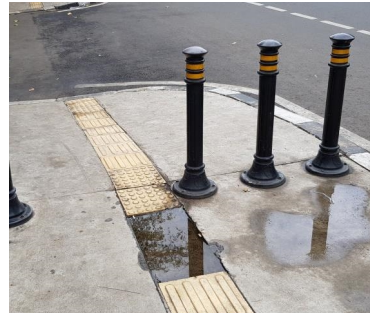
Gambar 23 jalur khusus tunanetra rusak
