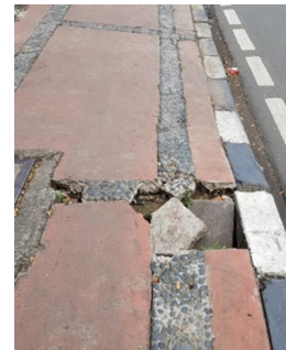
Gambar 37 Jalur pedestrian tidak mempunyai jalur tactile paving dan kondisinya berlubang Sumber: Dokumentasi penulis, Januari 2018
