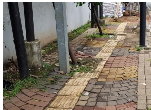
Gambar 29 Tiang listrik, telepon dll yang menghalangi jalan.
