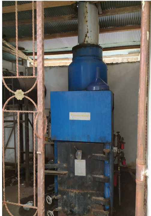
Gambar 3. Incinerator Rumah Sakit Bhayangkara Kota Palangka Raya Kalimantan Tengah
